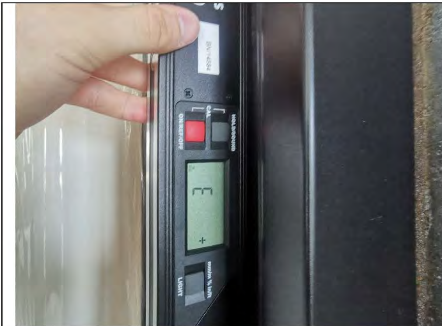
Фото №34. Отклонение корпуса входного дверного блока.
