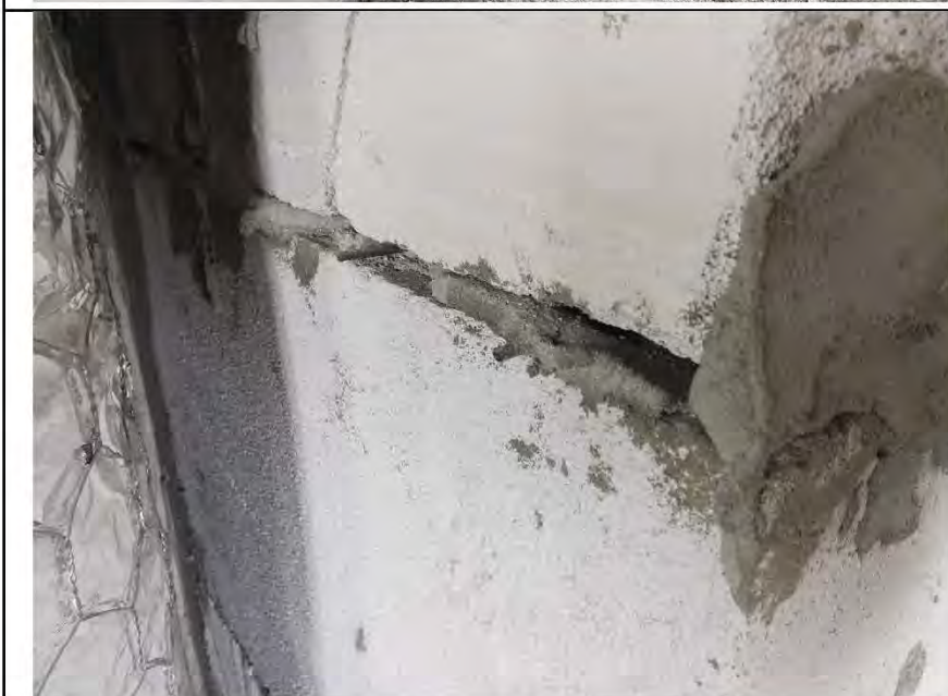
Фото №21. Некачественное выполнение швов кладки из ячеистых бетонных блоков в ванной комнате.
