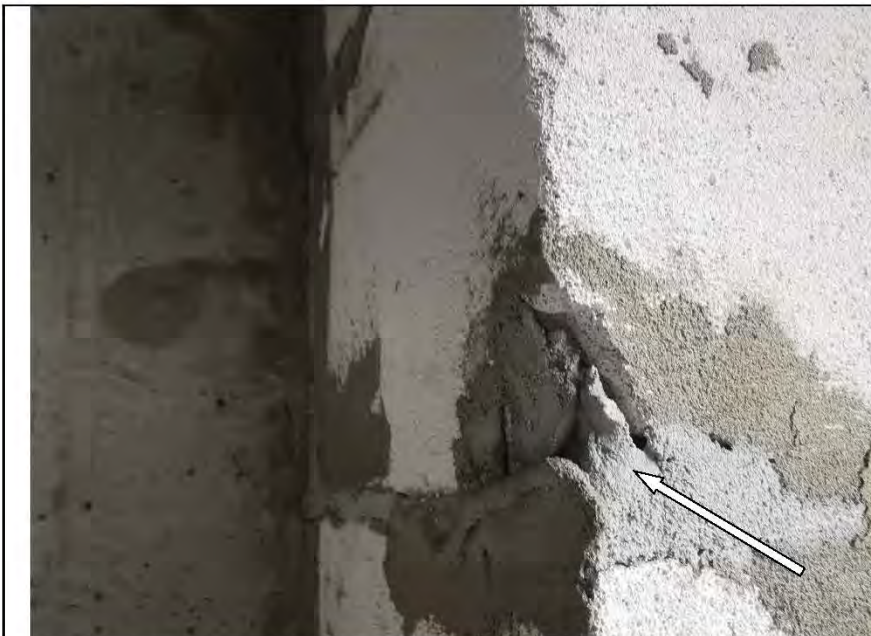
Фото №19. Некачественное выполнение швов кладки из ячеистых бетонных блоков в кухне.
