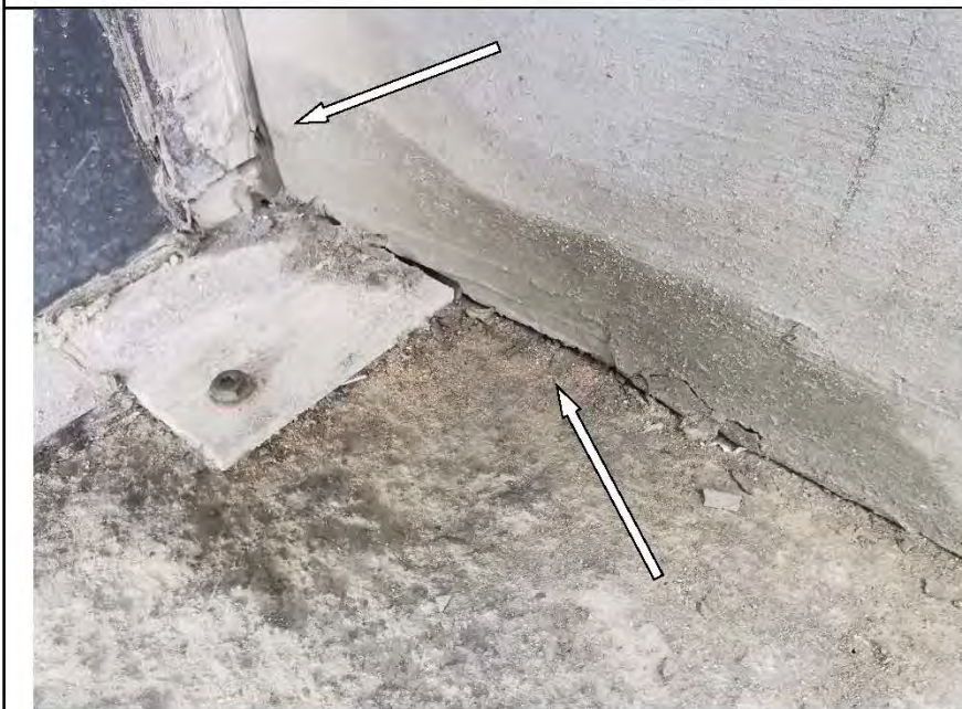
Фото №32. Некачественное выполнение узла примыкания металлического оконного блока к стене на лоджии..
