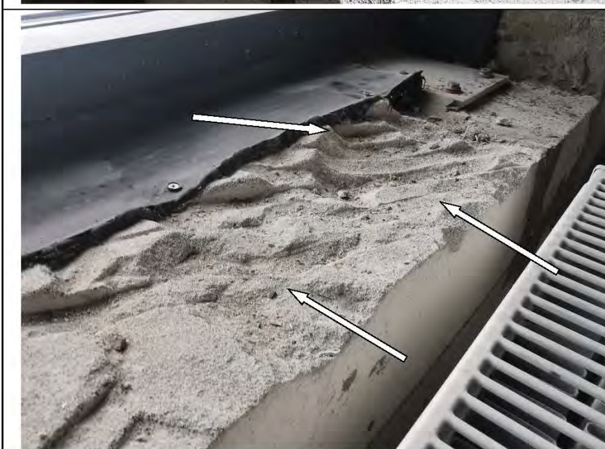
Фото №18. Отсутствие однородности внешнего вида блоков из ячеистого бетона в гостиной.
