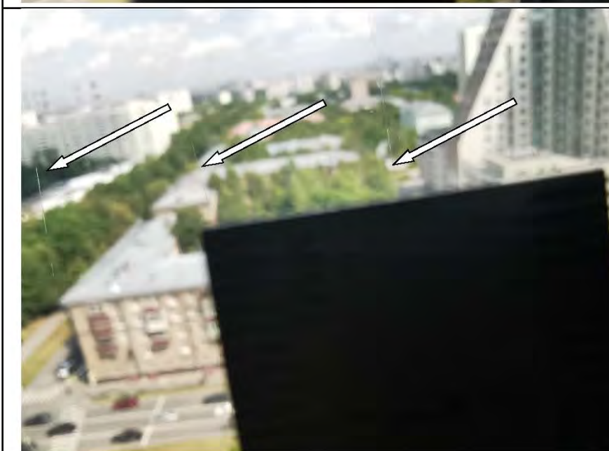
Фото №27. Царапины на стеклопакете металлического оконного блока в гостиной.
