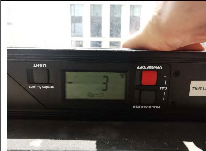
Фото №25. Отклонение металлического оконного блока от уровня горизонтальности в кухне.
