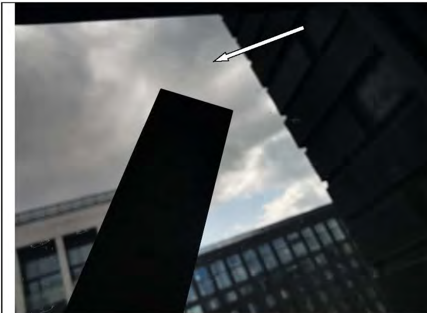
Фото №28. Царапины на стеклопакете металлического оконного блока в кухне.
