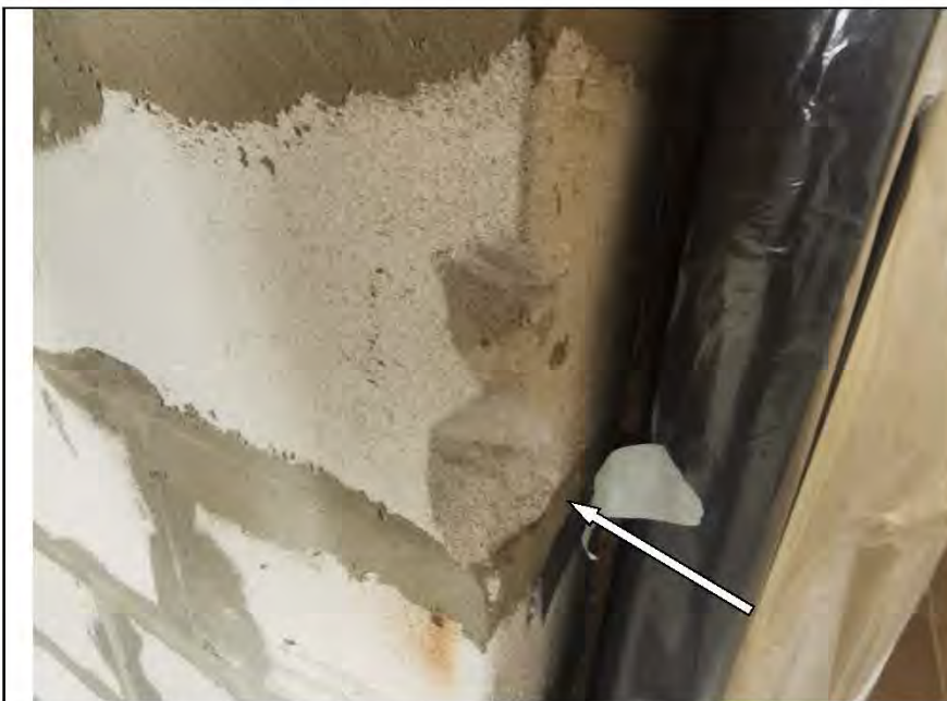
Фото №16. Скол на угле блока из ячеистого бетона в коридоре.
