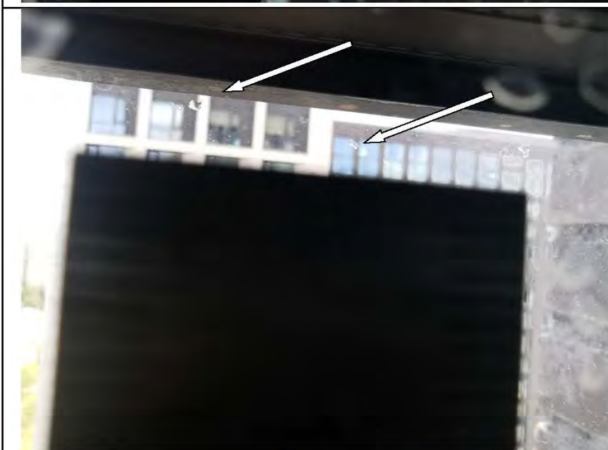
Фото №29. Окалины на стеклопакете металлического оконного блока в кухне.
