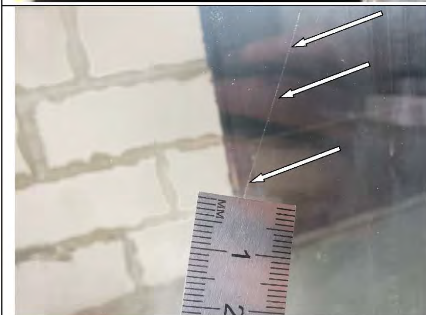
Фото №30. Царапины на стеклопакете металлического оконного блока на лоджии.
