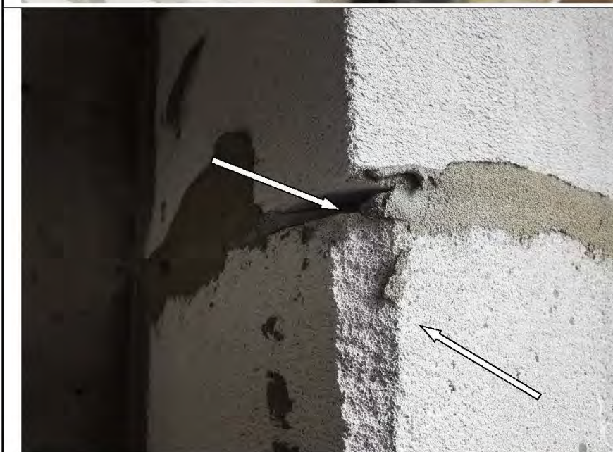
Фото №17. Скол на угле блока из ячеистого бетона в кухне. Некачественное выполнение швов кладки из ячеистых бетонных блоков в кухне.
