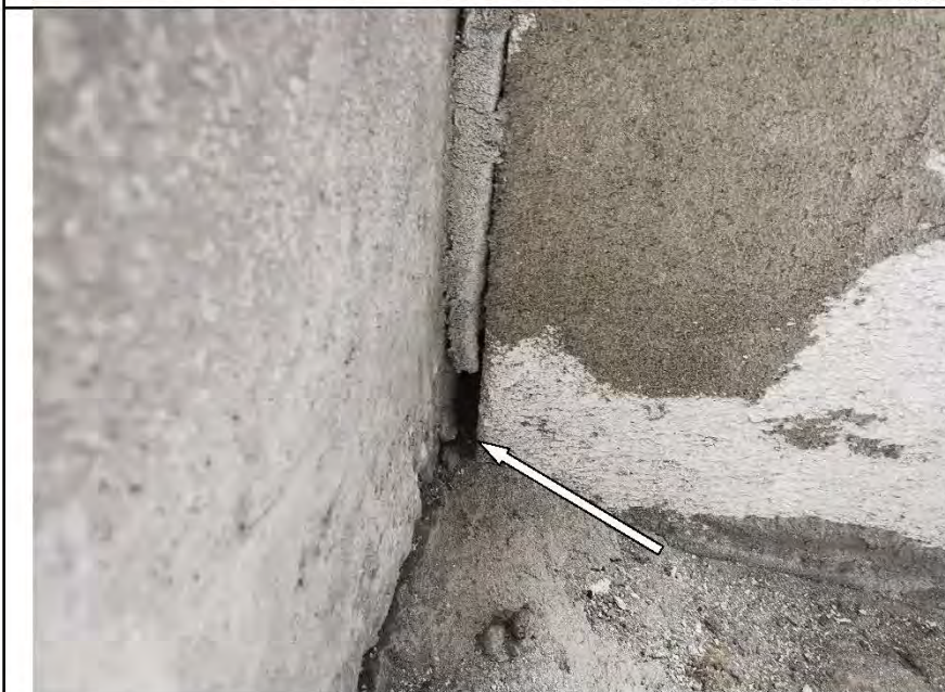
Фото №20. Некачественное выполнение швов кладки из ячеистых бетонных блоков в кухне.
