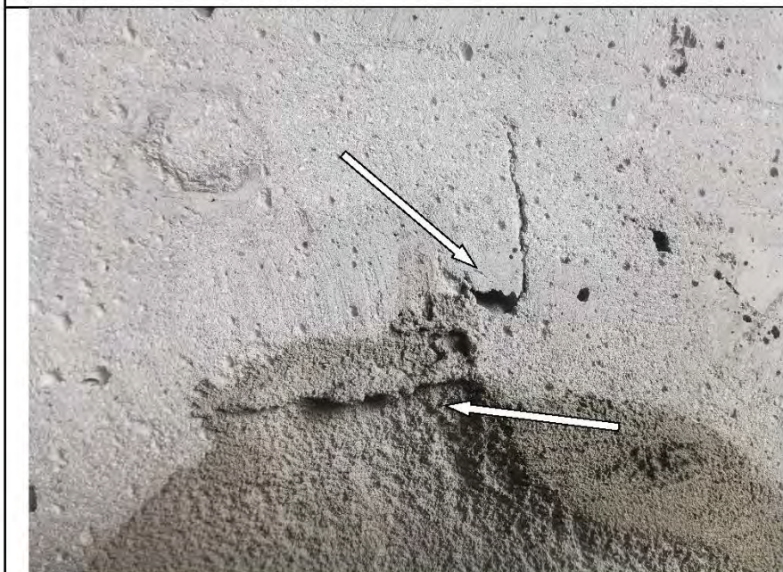
Фото №14. Отсутствие однородности внешнего вида поверхности железобетонного пилона в коридоре.
