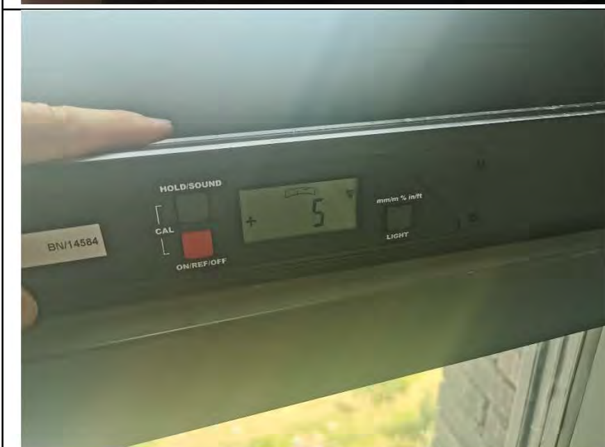
Фото №24. Отклонение металлического оконного блока от уровня горизонтальности в спальне.
