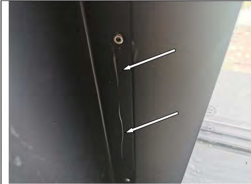
Фото №31. Царапины на профиле металлического оконного блока в спальне.
