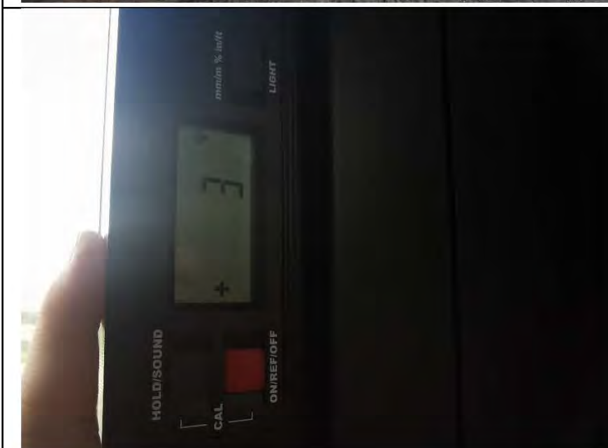
Фото №23. Отклонение металлического оконного блока от уровня вертикальности в гостиной.
