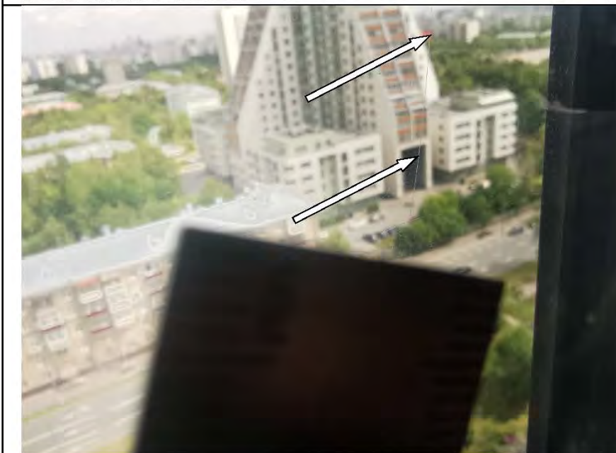
Фото №26. Царапины на стеклопакете металлического оконного блока в спальне.
